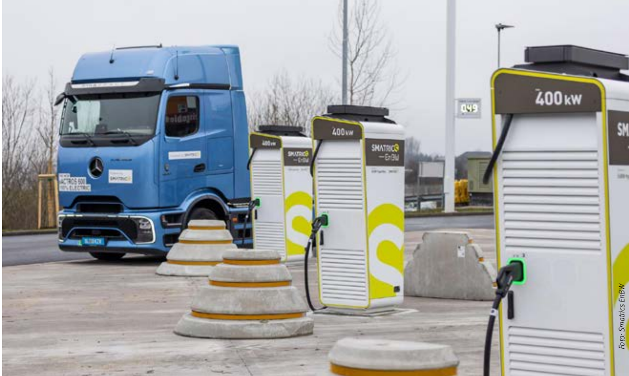
Smatrics EnBW betreibt in Regau in Oberösterreich einen Ladepark mit Ultraschnellladern für LKW und PKW.
