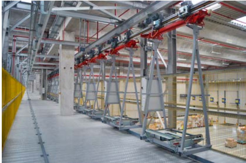
Fastmove arbeitet auch in Umgebungen mit Tiefkühltemperaturen von -30^{\circ}\text{C} .
