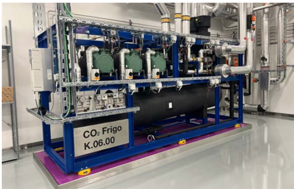
Kälteanlage Tiefkühlung bei Galliker mit dem natürlichen Kältemittel CO 2 .
