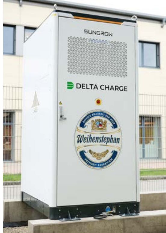
Das modulare Batteriespeichersystem wird vom Energiemanagementsystem von Delta Charge gesteuert.
