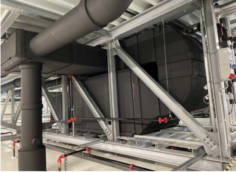
Die Wolf RLT-Geräte und auch die gesamte Verrohrung wurden mit 25 mm Kautschuk isoliert, um besonders bei schwülen Wetterlagen im Sommer zu verhindern, dass der Taupunkt an den Oberflächen unterschritten wird und unkontrolliert Kondensat anfällt.
