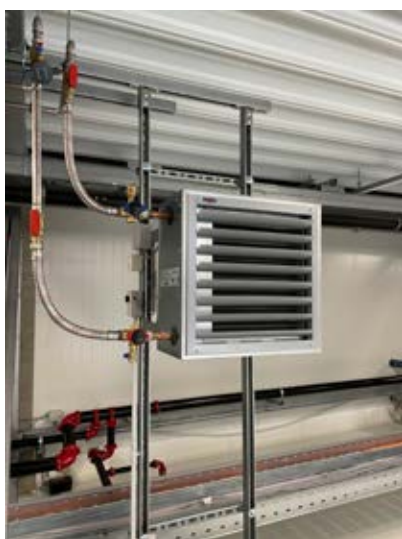
Luftheizer von Wolf erwärmen die Technikenebene oberhalb der TK-Bereiche auf mindestens 10^{\circ}\text{C} . Auf diese Weise soll ein Einfrieren der Sprinkleranlage verhindert werden.
