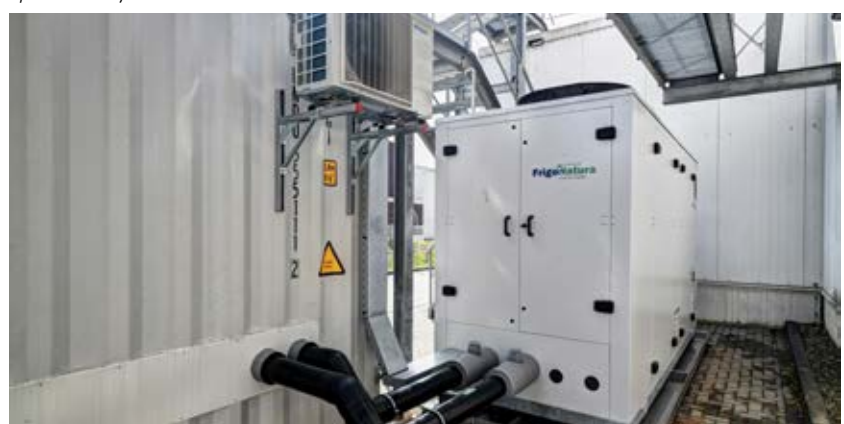
Der Frigonatura Propan-Flüssigkeitskühlsatz vor dem Fruchthof Northeim. Die Pufferspeicher befinden sich im Container daneben.
