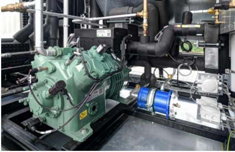
Zwei Ecoline Pro Vier-Zylinder-Hubkolbenverdichter von Bitzer sind das Herz des beim Fruchthof Northeim eingesetzten Flüssigkeitskühlsatzes.
