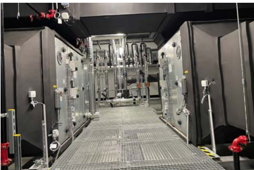
Zehn Lüftungsgeräte ohne Wärmerückgewinnung wurden jeweils nebeneinander installiert: Ein Geräteblock besteht aus einem Zu- und einem Abluftteil, parallel dazu ist jeweils redundant ein zweites Gerät ausschließlich für den Umluftbetrieb installiert. Dadurch wird die Kühlung über die Fläche sichergestellt.
