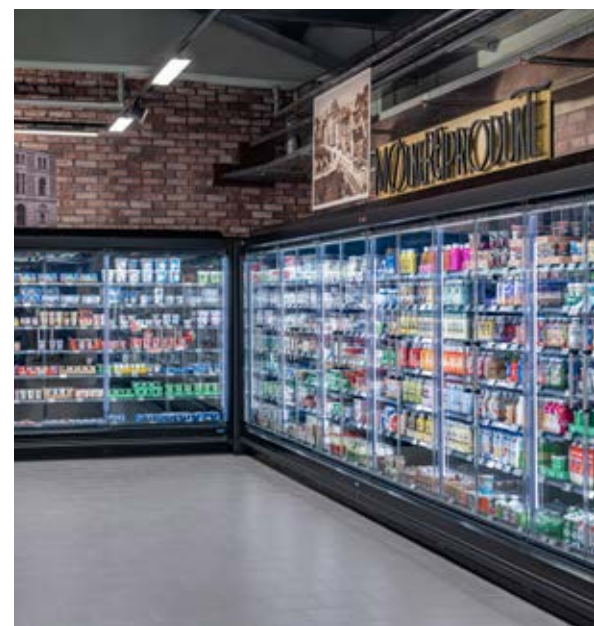
Großflächige Glastüren schaffen optimale Sicht auf die Artikel und helfen, Energie einzusparen.
