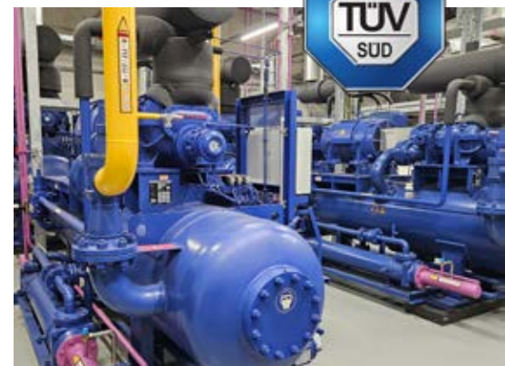
Ammoniak-Kälteanlage in einem Kühlhaus
