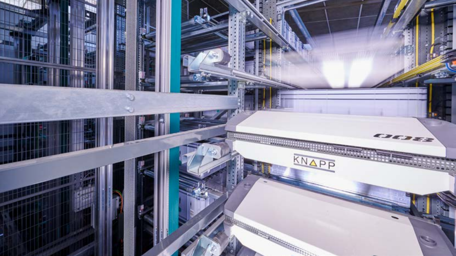
Dreh- und Angelpunkt der automatisierten Abläufe bei Shufersal ist das OSR Shuttle Evo von Knapp.
