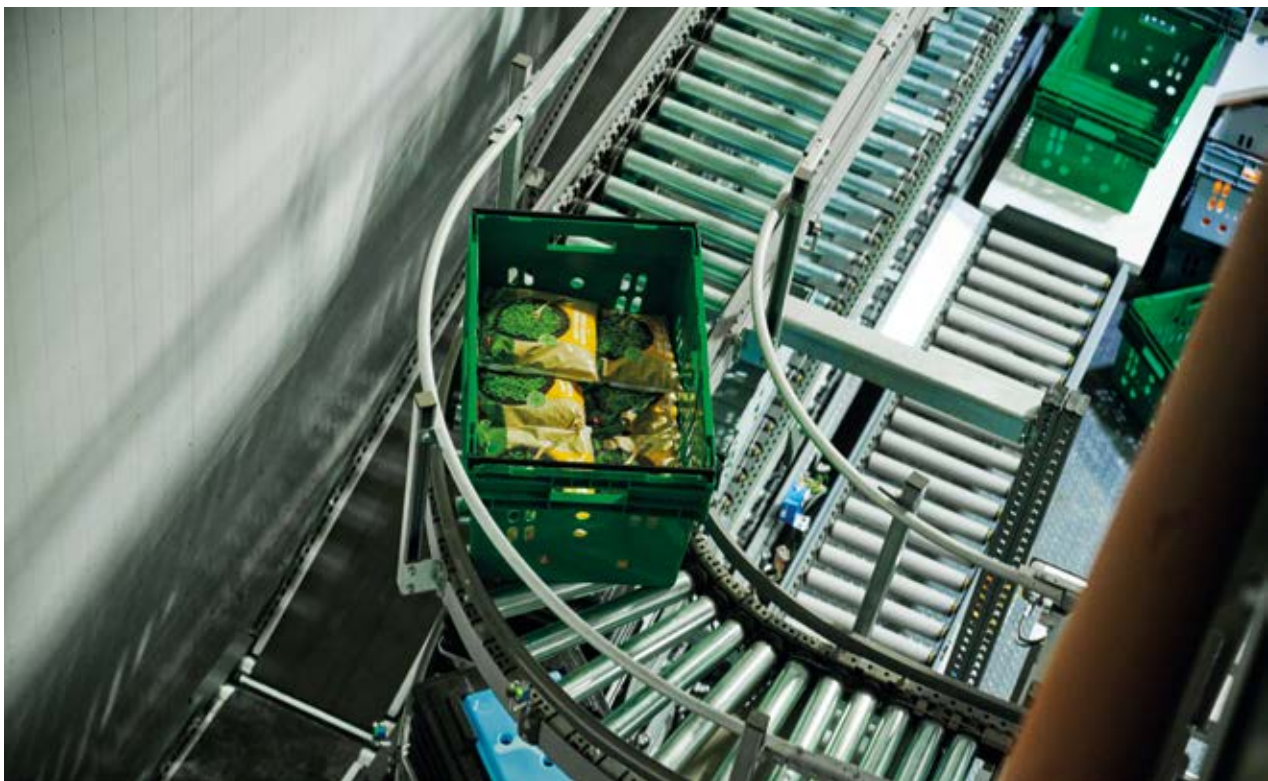
Auf den Auftragsbehältern mit Tiefkühlprodukten werden bei Shufersal Deckel mit integrierten Icebags appliziert, die ebenfalls im Shuttlesystem ein- und ausgelagert werden.
