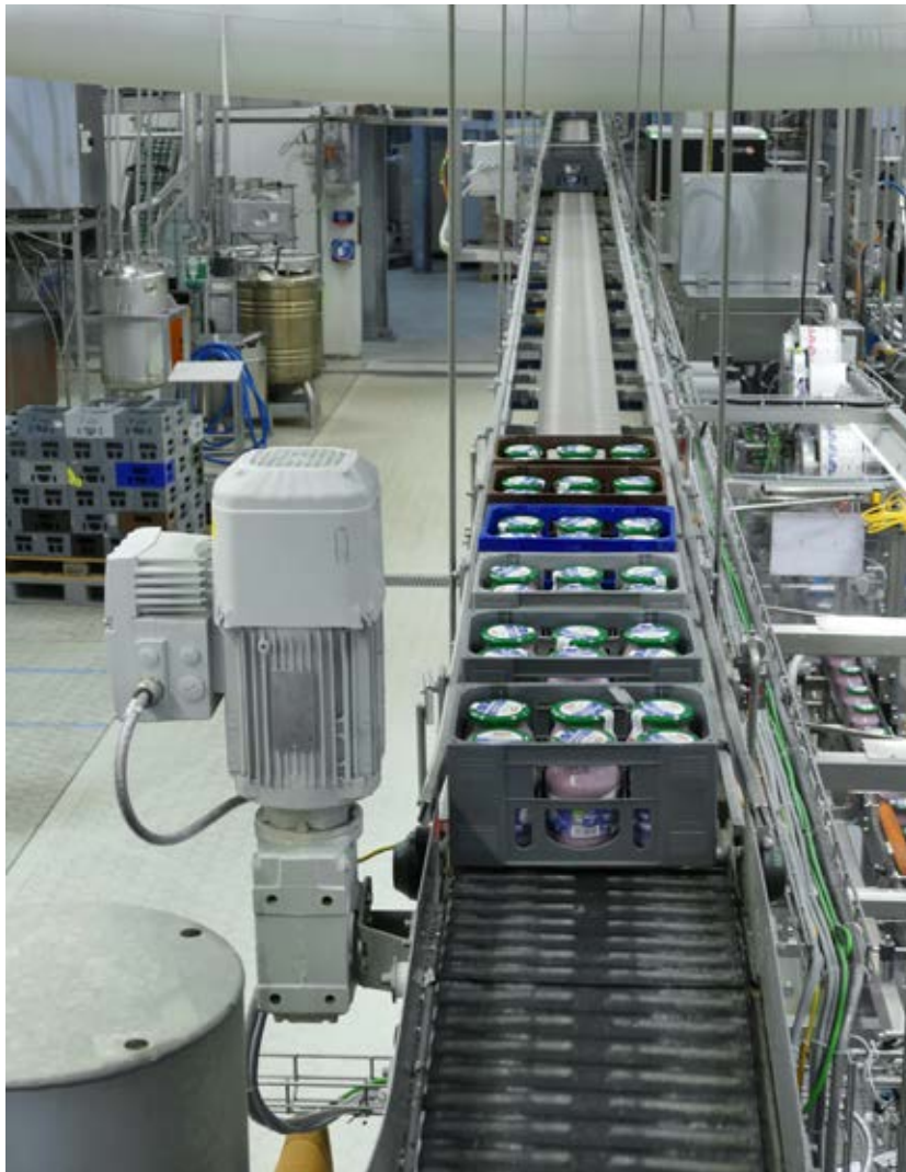
Die gefüllten Sechser-Stiegen mit 500-Gramm-Joghurtgläsern werden über ein Förderband zur Logistik weitergeleitet. Der dezentrale Antrieb Movimot Performance von SEW-Eurodrive – vorn im Bild – sorgt für den kraftvollen Antrieb des vorgelagerten Spiralförderers.
