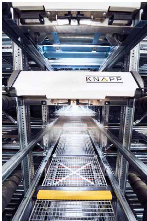
Das Herzstück des Lagers bildet das Lager- und Kommissioniersystem OSR Shuttle. Für fertiggestellte Aufträge dient es zudem als Versandpuffer.
