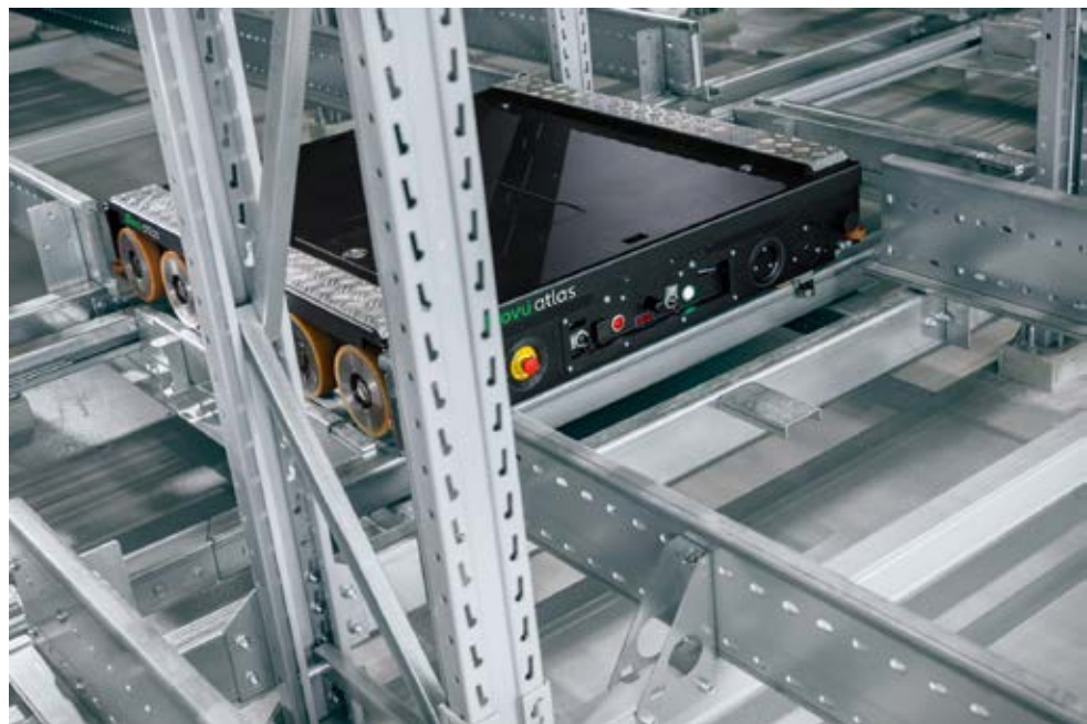
Das Herzstück der Anlage bei Bio-Frost Westhof bildet ein Movu Shuttlesystem.
