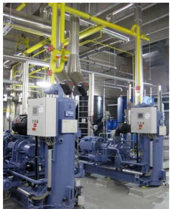
Ammoniak-Kälteanlage in einem Kühlhaus
